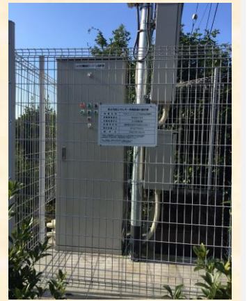
戸田新田 小水力発電設備
